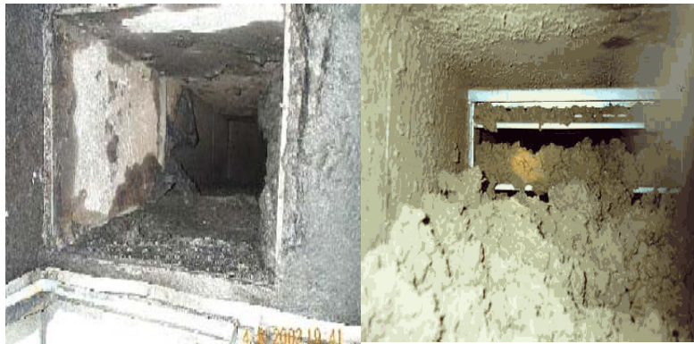
تصویر (۳۶) انباشته شدن گردو غبار در کانالهای مجرای عبور هوا شرایط را برای رشد و نمو انواع موجودات ریز ذره بینی فراهم می کند
